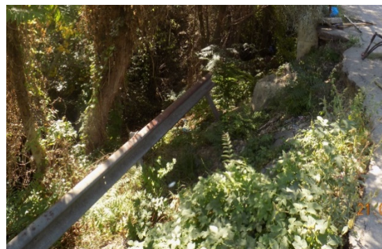
b. Embankment rift
